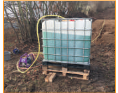
Wärmeträgerflüssigkeit für die Befüllung der Anlage bis -16°C.
