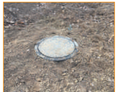
Der Schachtdeckel (150 KG belastbar) zeigt den Standort des Verteilerschachtes. Mehr ist von der Erdwärmeanlage nicht mehr zu sehen.
