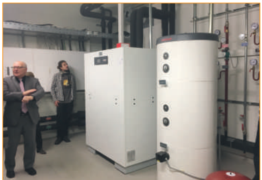
Ein Blick in den Technikraum. Als Wärmepumpe wurde hier ein Gerät der Firma Weishaupt verbaut.
