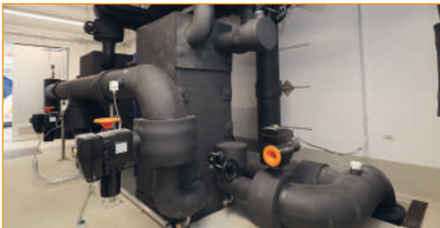
Die Pumpenanlage für die kalte Nahwärme bei den Stadtwerken in Friedberg.
