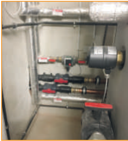
Installation im Technikraum. Hier kommen die Leitungen aus dem Feld und gehen wieder zurück.
