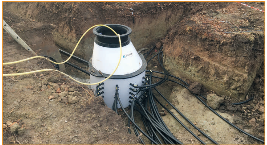
Verteilerschacht als Zusammenführung bei Erdwärmeprojekten.
