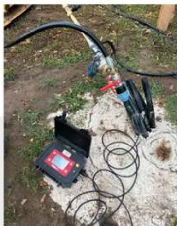
Abb. 13 Druck- und Durchflussmessung mit Geräten der Firma Esders
