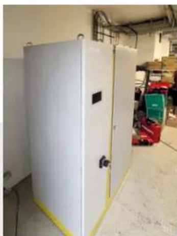
Abb. 25 Blick in den Technik-raum mit Wärmepumpe.
