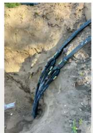
Abb. 18 Erdwärmesonden mit Rohrzusammenführungen
