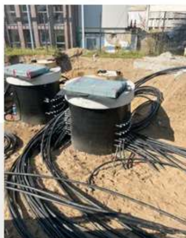
Abb. 21 Verteilerschächte mit angeschweißten Anbindeleitungen.
