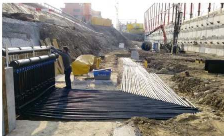
Abb. 1 Eine 22-fach Verteileranlage für die Baustelle in Malers.
