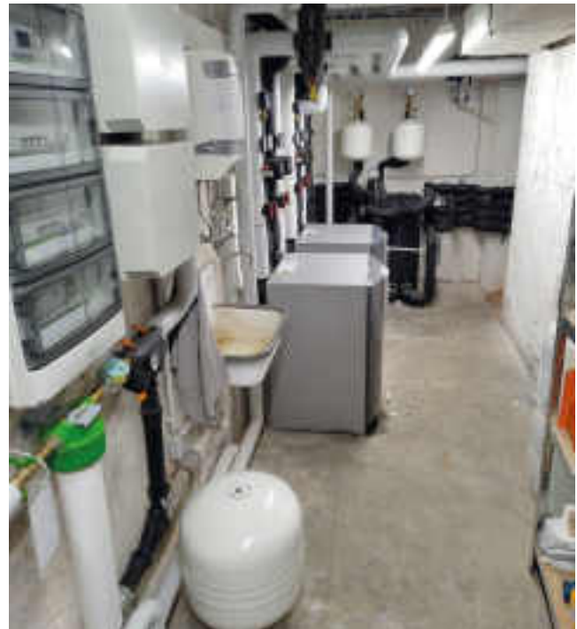
Abb. 1 Blick in den Technikraum mit den Wärmepumpen.
